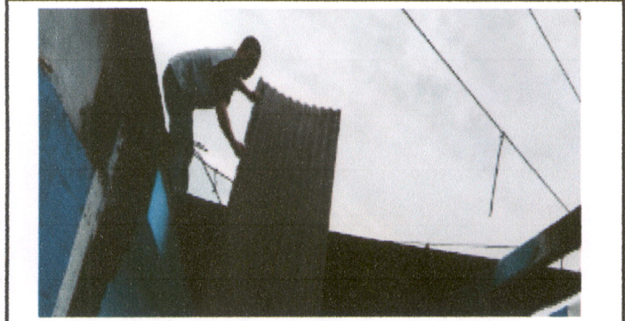
Foto1: Sustitución de lámina, por lámina troquelada aluzinc calibre 26, sustitución de estructura de soporte de metal por metal, se realiza la desinstalación de la estructura portante y lamina existente en mal estado,
