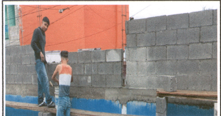
Foto 3: Reparación de muro perimetral de block, realización de soleras e hileras de block para reforzar el muro perimetral
